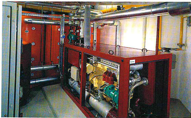
Brennwert-BHKW "Gymnasium Bingen" mit 50 kW elektrischer Leistung
