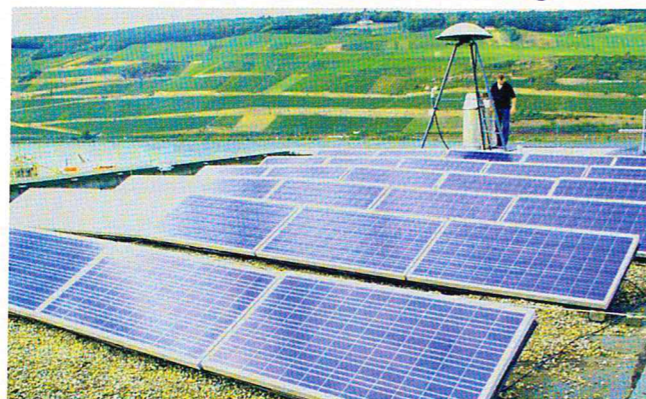
PV-Anlage "Berufsbildende Schule Bingen" mit 5 kW elektrischer Leistung
